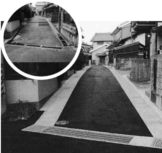
▲補助金を受けて整備された私道の道路側溝(丸囲みは整備前の様子)
