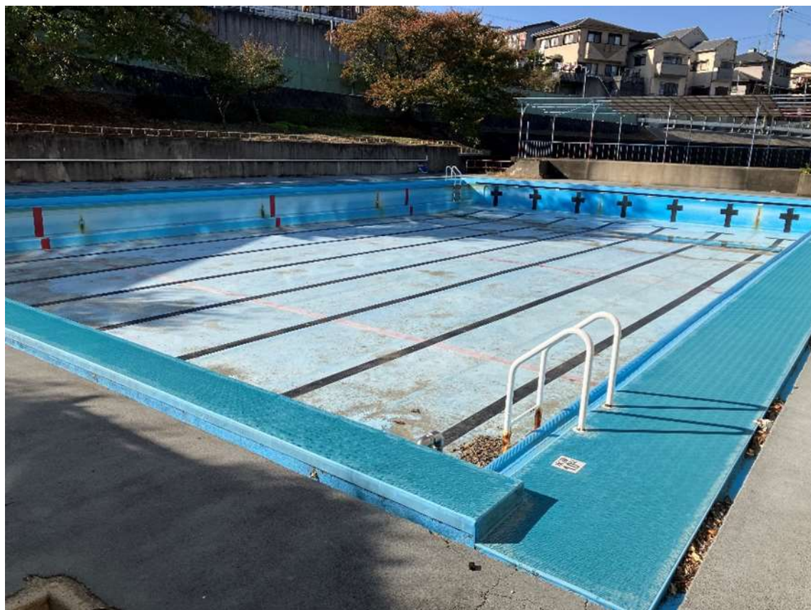
宇治中学校プール設備【写真】
