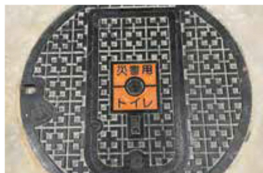
▲マンホールトイレ・災害時貯留槽 （平塚市消防署本署）
