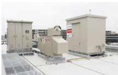
▲非常用発電設備 （平塚市消防署本署）
